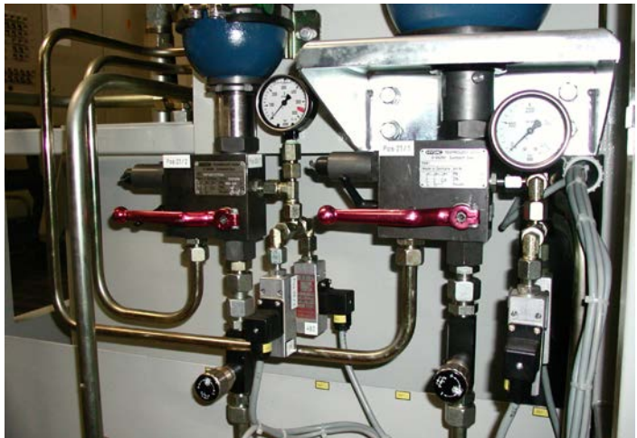
Abb. 25 Druckentlastete Hydrospeicher mit abgesperrten Druckleitungen
